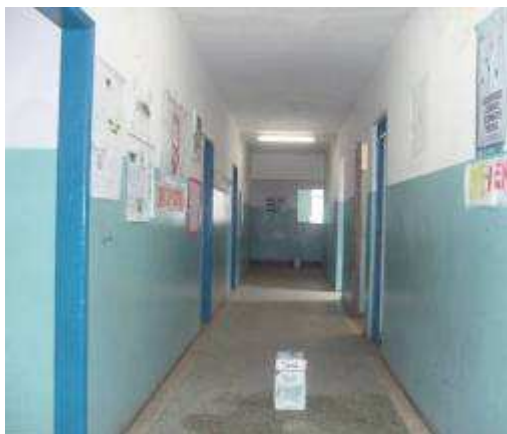
Figura 17 - Corredor da Escola tomado por goteiras.
