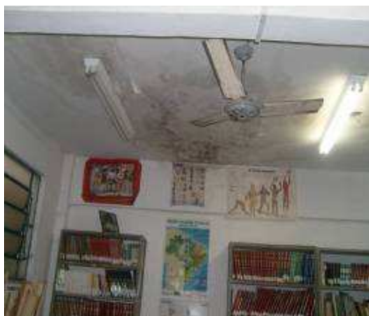
Figura 19 - O espaço reservado à biblioteca também não escapa das goteiras.
